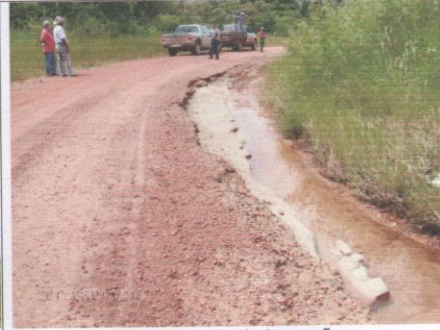
Trecho necessitando de correção
