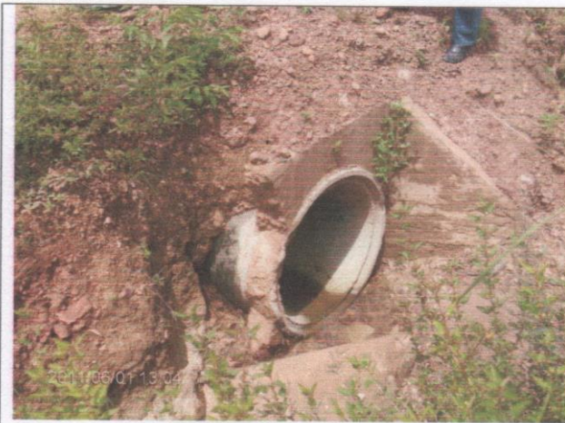
bstc de 1,00m necessitando de correção
