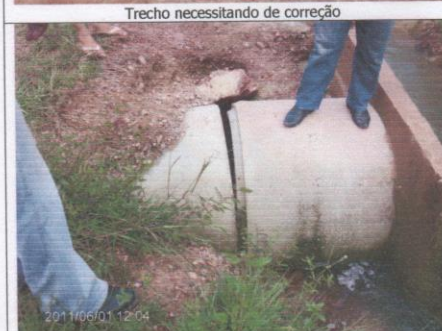
bsta de 1,00m mal rejuntado
