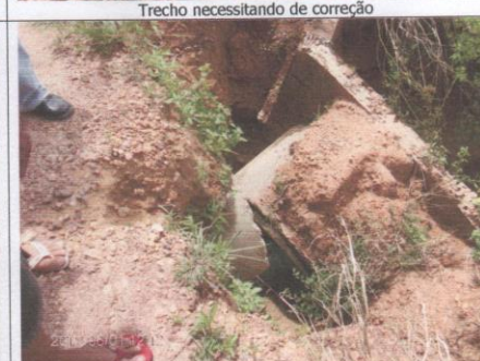
bsta de 1,00 precisando de reparos
